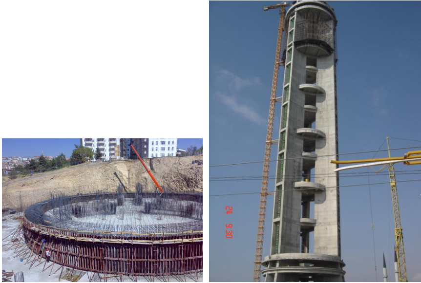
Resim 1,2 : İlgaz Grup bünyesindeki Fil inaat tarafından Ankara Keçiören'de yapımı sürdürülen 186 metre yükseklikteki Cumhuriyet Kulesi inaat,
