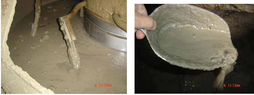
Resim 28, 29. Beton santralindeki su kaçaklar,ndan dolay, beton kalitesinde meydana gelen görüntü.
