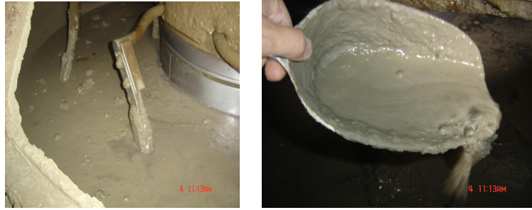
Resim 22, 23. Beton santralindeki su kaçağlarından dolayı, beton kalitesinde meydana gelen problem.
