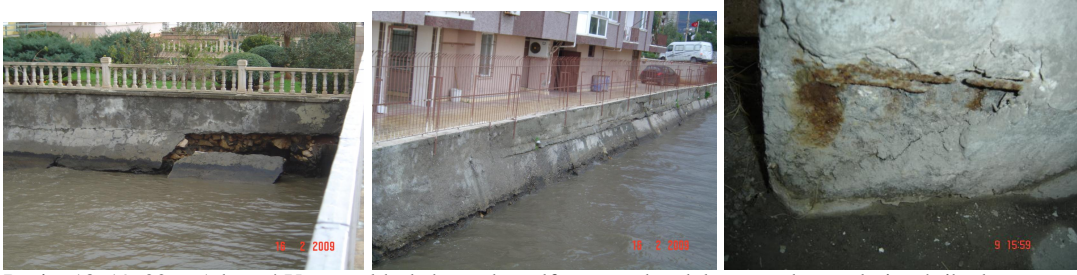
Resim 18, 19, 20. Adana 6 Yumurtal, kılda betonda, sülfat ata ndan dolayı, meydana gelmi tahribatlar.
