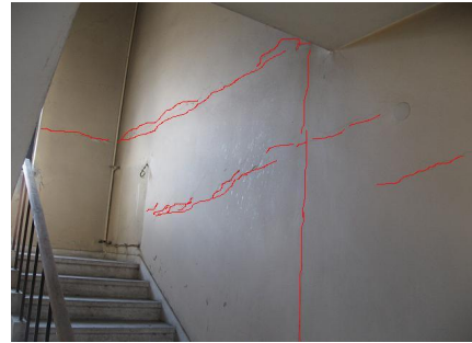
ekil 2. Duvar çatlakları.
