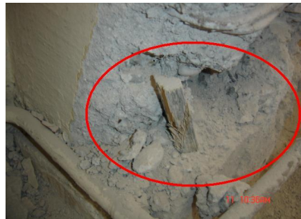
ekil 3. Çekirdek betonu üzerindeki zay,f bölgeler.
